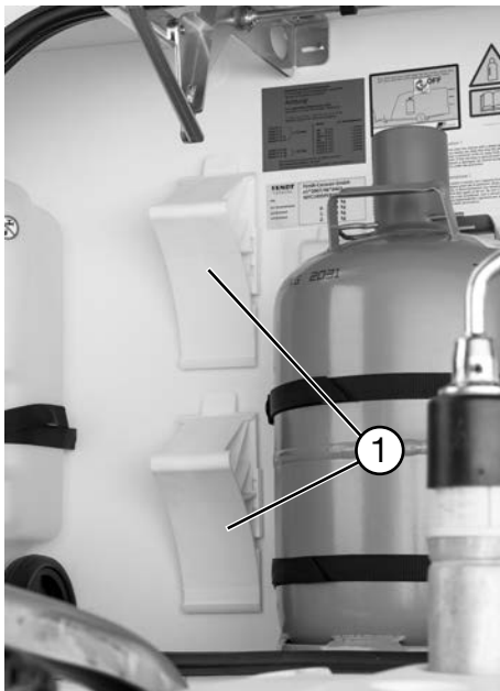
Onderlegwiggen in de gasfleskast
